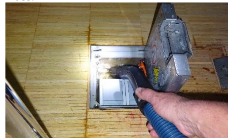
Wasser im Elektroschacht
