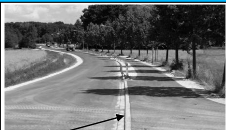
Diese „Granitsteine, auch wenn sie nur 3 cm hoch, aber scharfkantig sind, stellen für die Radfahrer bei der Auffahrt ein gefährliches Hindernis dar.“
